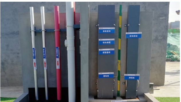
水井电井样板
