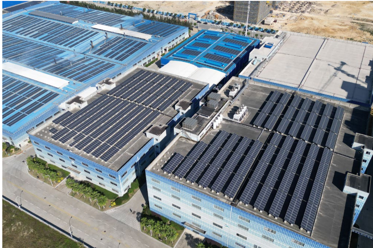
佛山光伏电站
